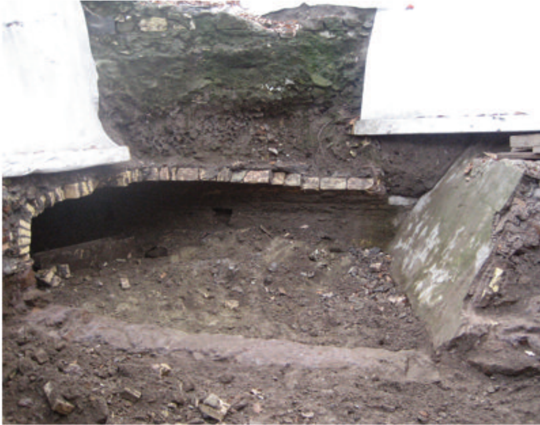
34. VIA SANNIO. GIARDINO PUBBLICO. PERIODO 10: OPERA DI SCORRIMENTO D'ACQUA RELATIVA AI MULINI SULLA MARRANA DELL'ACQUA MARIANA (foto SS-Col)
