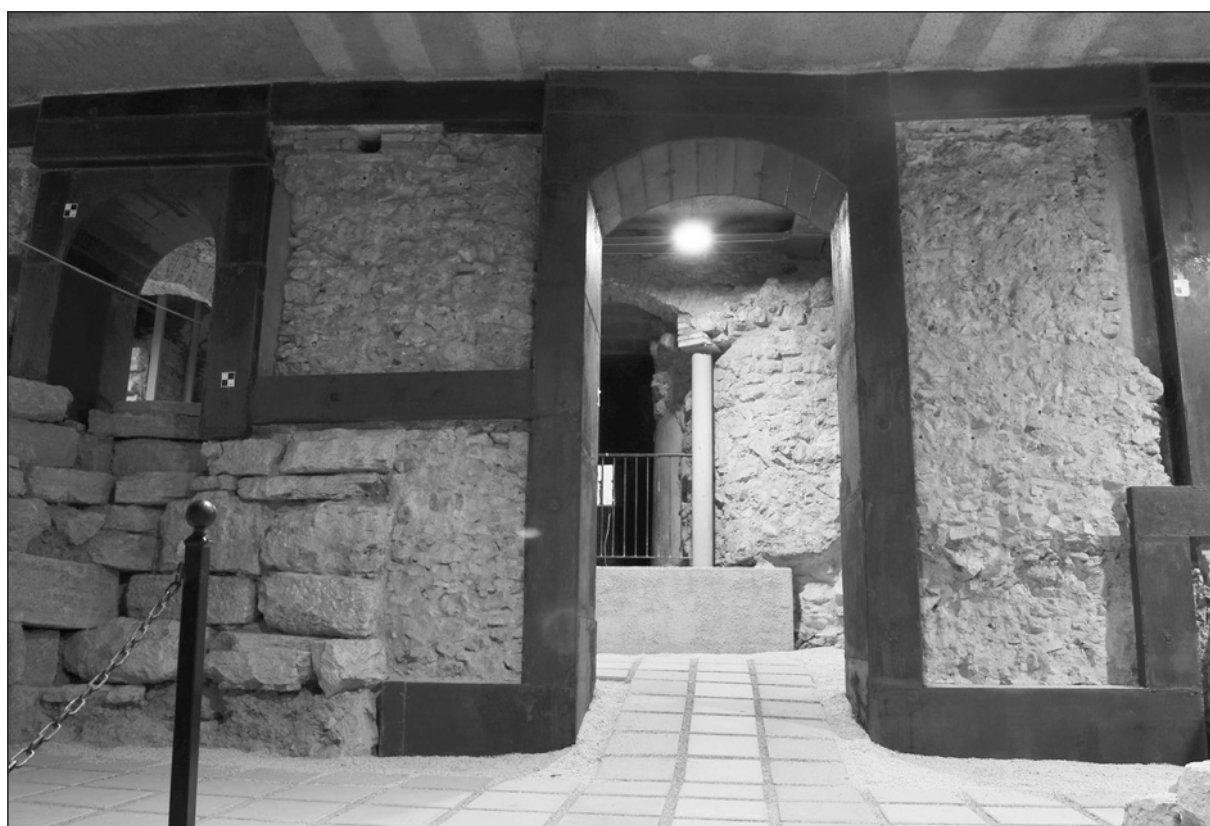
20. FONDAZIONI DEI PILASTRI DEL LOGGIATO ADIACENTE ALL'ABSIDE DELLA CATTEDRALE PORTATE IN LUCE DAGLI SCAVI, CON LE STRUTTURE METALLICHE DI RINFORZO CHE SI SONO POI RESE NECESSARIE (foto Autori)
