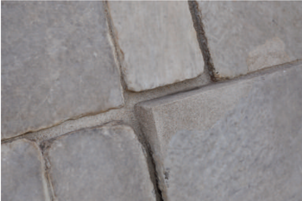
17. ROMA. PIRAMIDE DI CAIO CESTIO. RICONFIGURAZIONE DEL PARAMENTO LAPIDEO E STILATURA DEI GIUNTI
