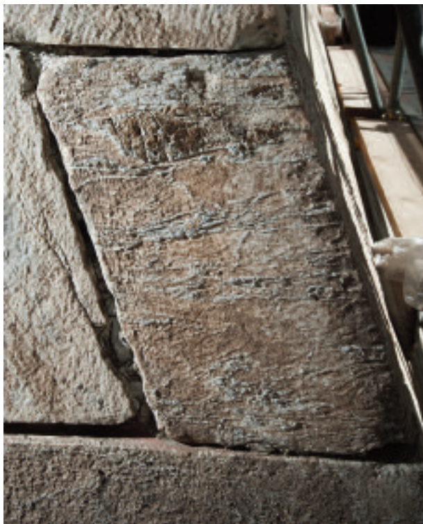
3. ROMA. PIRAMIDE DI CAIO CESTIO. DETTAGLIO DELLA DISGREGAZIONE DELLA PIETRA
