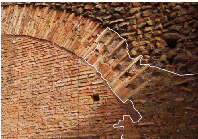
7. SCAVI DI OSTIA. CASERMA DEI VIGILI, 1911. RIPROPOSIZIONE DELLE TECNICHE DI AMMORSATURA SUI RESTI DELLA GHIERA. LA RIPRESA DELLA VOLTA SEZIONATA SI ISPIRA ALLE CARATTERISTICHE DI TESSITURA DEL NUCLEO. IN BIANCO EVIDENZIATE LE MEMBRATURE ANTICHE
