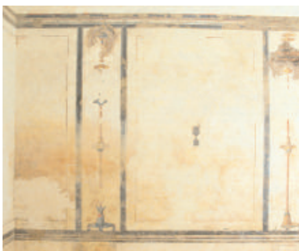
20. ROMA. PIRAMIDE DI CAIO CESTIO. INTERNO DOPO IL RESTAURO. PARTICOLARE PARETE N-E. LE LACUNE DELLE DECORAZIONI NON SONO STATE RISARCITE
