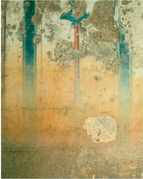
7. ROMA. PIRAMIDE DI CAIO CESTIO. INTERNO. PARETE N-E PRIMA DEL RESTAURO. È EVIDENTE LO STRATO DI CALCARE GIALLO BRUNO CHE COPRE LA DECORAZIONE
