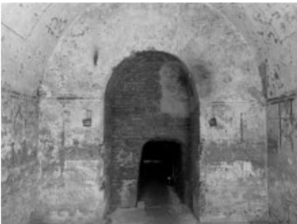
9. ROMA. PIRAMIDE DI CAIO CESTIO. INTERNO. A SIN. PARETE DI INGRESSO PRIMA DEL RESTAURO: SI NOTA LA PRESENZA DI DANNI ANTROPICI
