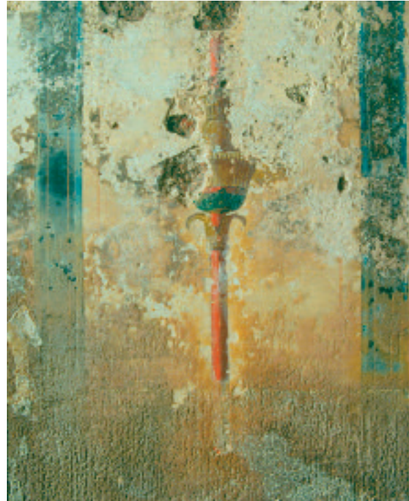
8. ROMA. PIRAMIDE DI CAIO CESTIO. INTERNO. PARETE N-E PRIMA DEL RESTAURO. SONO EVIDENTI LE EFFLORESCENZE SALINE
